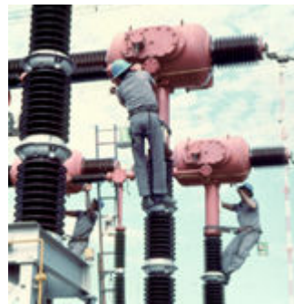
Funcionários fazem manutenção de subestação. A partir de 1967, a Cesp implantou três "linhões" de transmissão de eletricidade, que cruzam todo o Estado de São Paulo ponteados por subestações.
