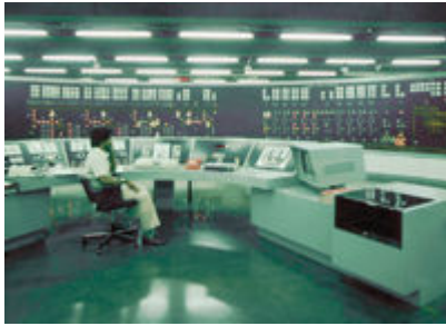
Sala de comando da Usina Hidrelétrica José Ermírio de Moraes, também conhecida como Água Vermelha. Em contraste com os centenas e até milhares de operários necessários para a construção de uma hidrelétrica, uma vez concluída requer poucos funcionários para operá-la e mantê-la.
